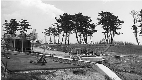
全壊した藤塚排水場
