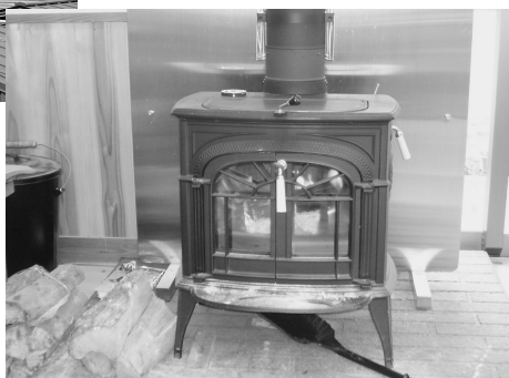
薪ストーブ (上勝中学校)
