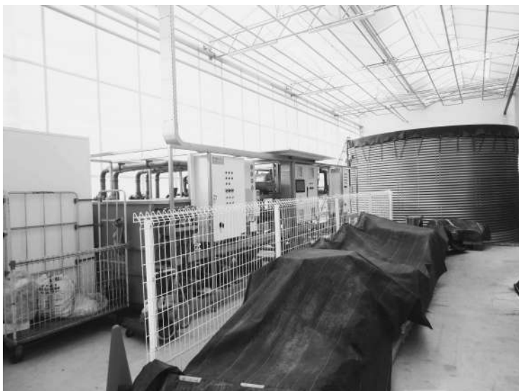
写真3 第一温室の環境制御装置。奥にボイラー設備が設置されている。
